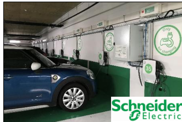
Test à Rueil-Malmaison, site Schneider Electric
